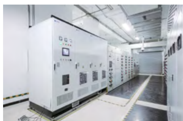
逆变回馈装置现场图
