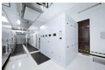
回馈变压器现场图
